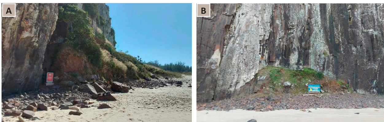
Figura 26 - Imagem da face leste da Torre Sul exibindo depósito de acúmulo de blocos rochosos (A); Imagem da face leste da Torre Sul exibindo depósito de acúmulo de blocos rochosos (B). Fonte: Elaborado pelos autores.
